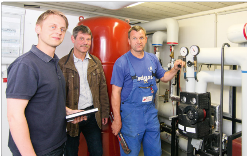
Bild: Stadtwerke-Mitarbeiter Michael Koark, Bauleiter Ulrich Chrazanowski und Monteur Mike Bunke an der Fernwärmeübergabestation. Foto: Stadtwerke Neuruppin
